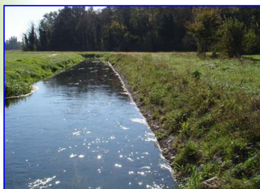
Foto 6 – Opera rinverdita a 5 mesi dal termine dei lavori (per gentile concessione Consorzio Bonifica Fossa Di Pozzolo – Mantova, Direttore Dott. Agr. Cesare Buzzacchi, Capo Area Ufficio Tecnico Ing. Oliviero Zucchini)
